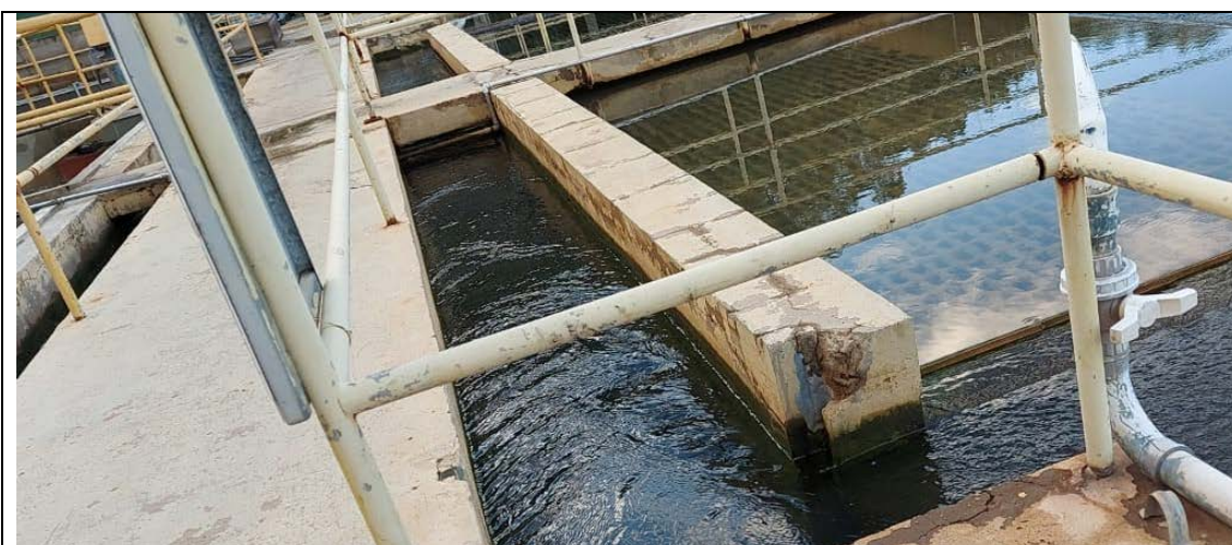
Fig. 10 - Saída do decantador 01 / calha de distribuição para os filtros
