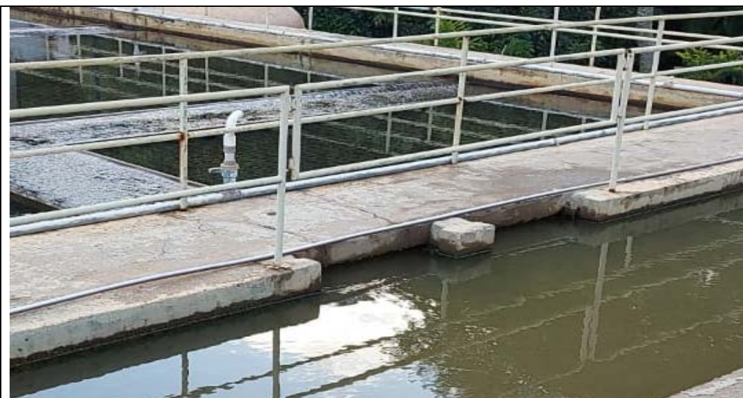
Fig. 01 - Saída da calha de estabilização / entrada no decantador 01
